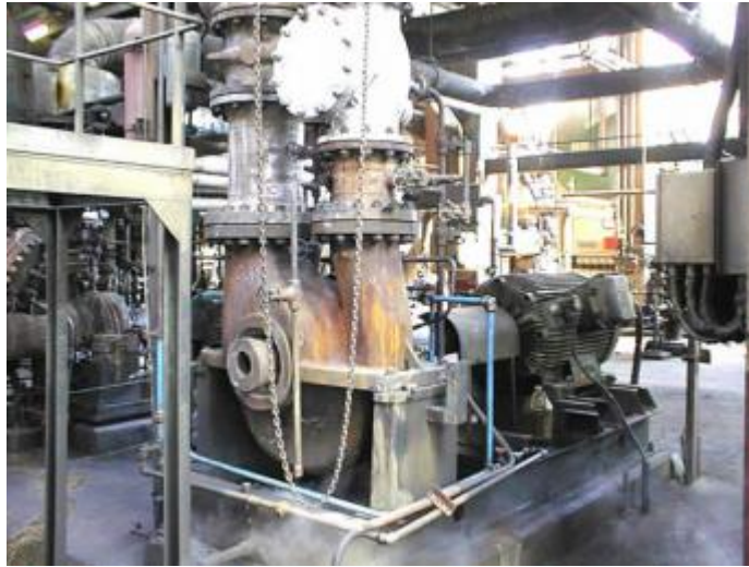
Figure 14: Pompe procédé, une seule roue en porte à faux
